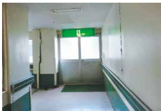
■ 管理棟 柱亀裂
