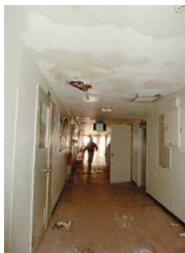
■ 管理棟 天井水もれ
