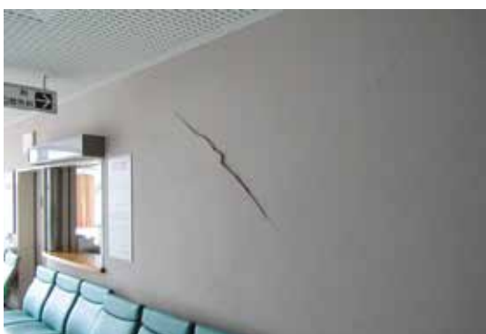
■ 口腔外科前 内壁亀裂
