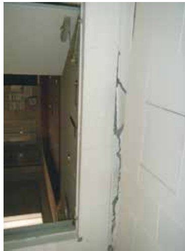
■ 中央病棟ホール付近 内壁亀裂
