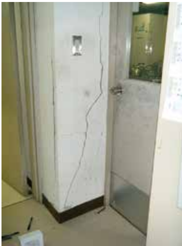
■ 中央病棟厨房 内壁亀裂
