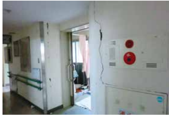
■ 中央病棟 廊下内壁亀裂
