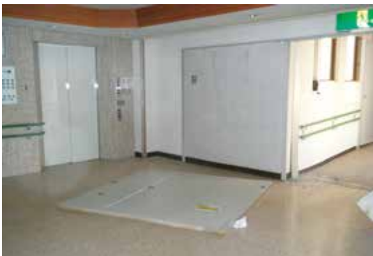
■ 中央病棟 防火扉脱落
