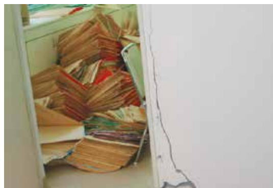
■ 健診センター 内壁亀裂
