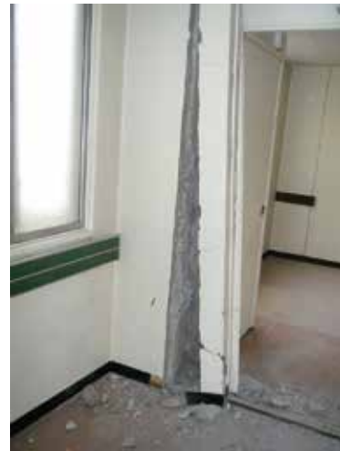
■ 中央病棟 柱亀裂
