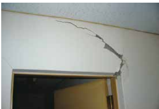
■ 管理棟 内壁亀裂
