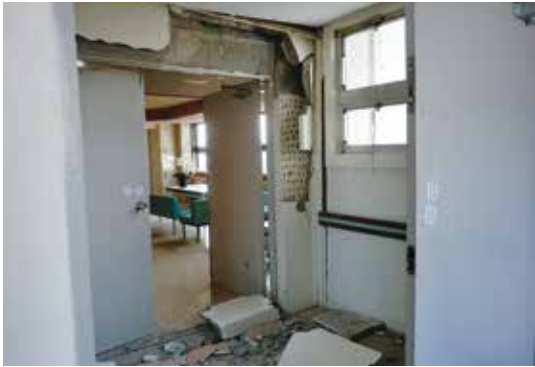
■ 中央病棟渡廊下 内壁一部崩落
