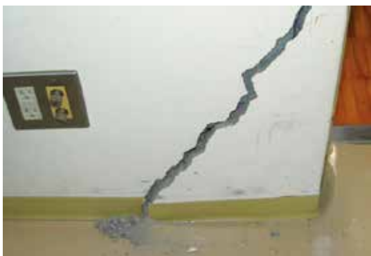
■ 健診センター 内壁亀裂
