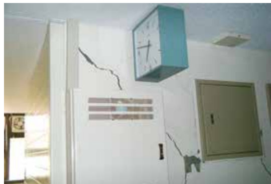
■ 中央病棟 廊下内壁亀裂
