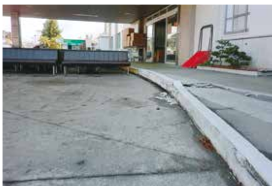
■ 玄関前スロープ 地盤沈下
