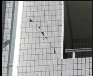
■ 診療棟 外壁亀裂
