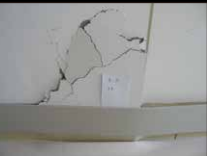
■ 健診センター 外壁亀裂
